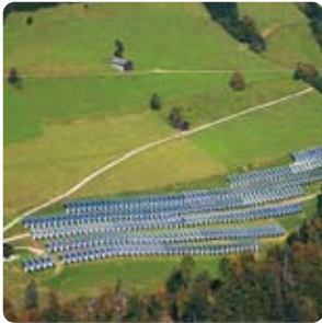
Pequeña central eléctrica
