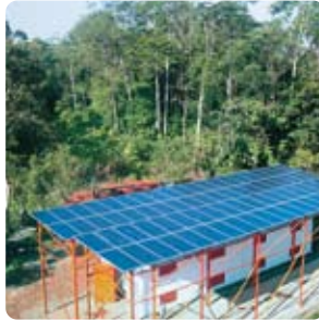
Sistema de telecomunicaciones
